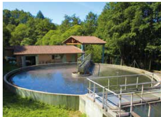
Station de traitement des eaux usées à AMBAZAC
