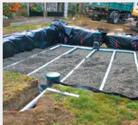
Drain de répartition sur un assainissement individuel
